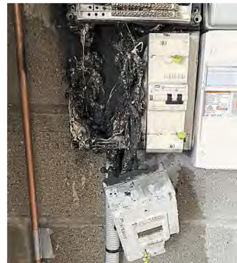
Le compteur Linky après le début d'incendie.
