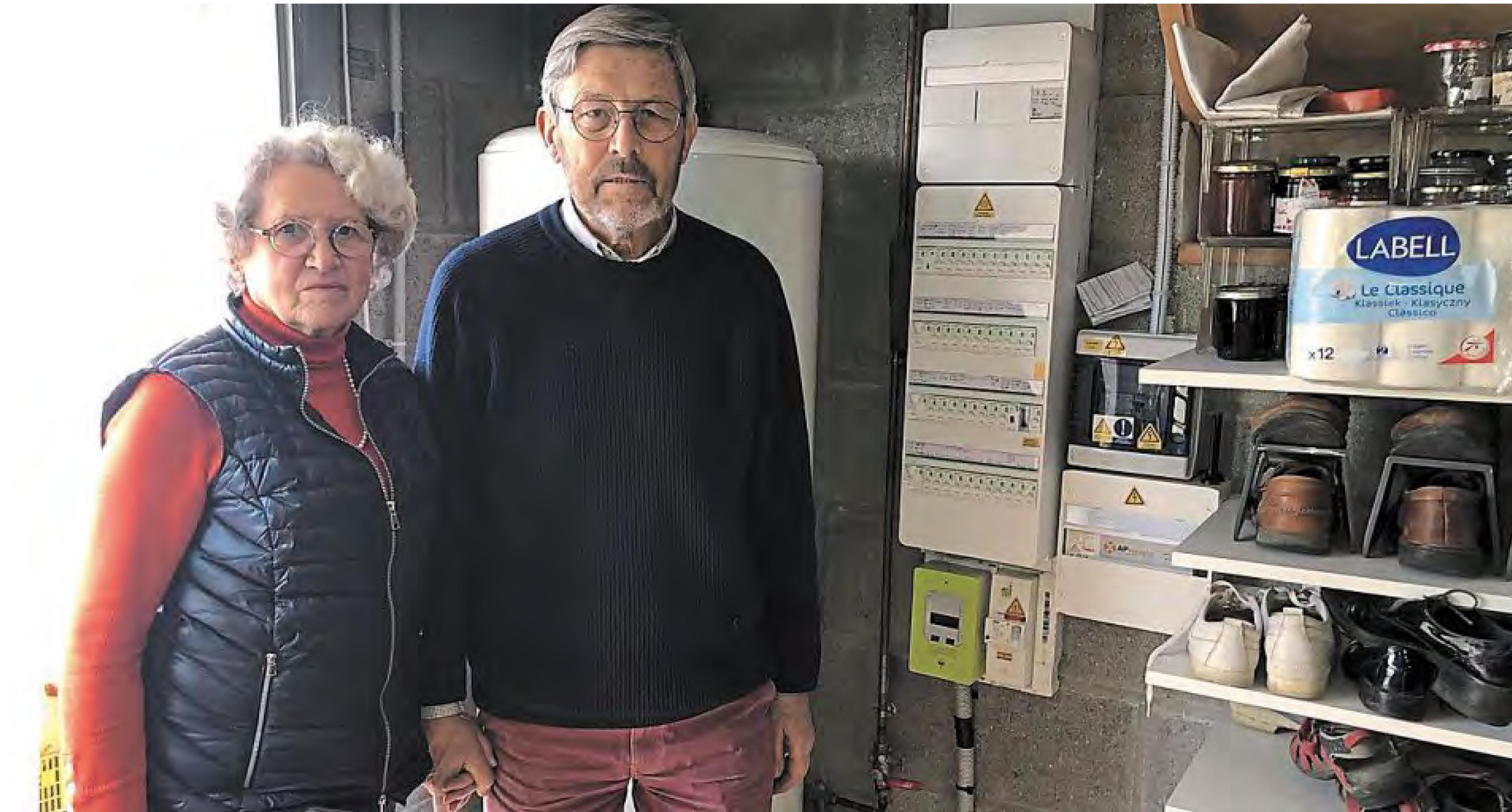
Les époux Morvant devant la nouvelle armoire électrique et le compteur Linky qui a pris feu dans leur maison de Saint-Philibert.
