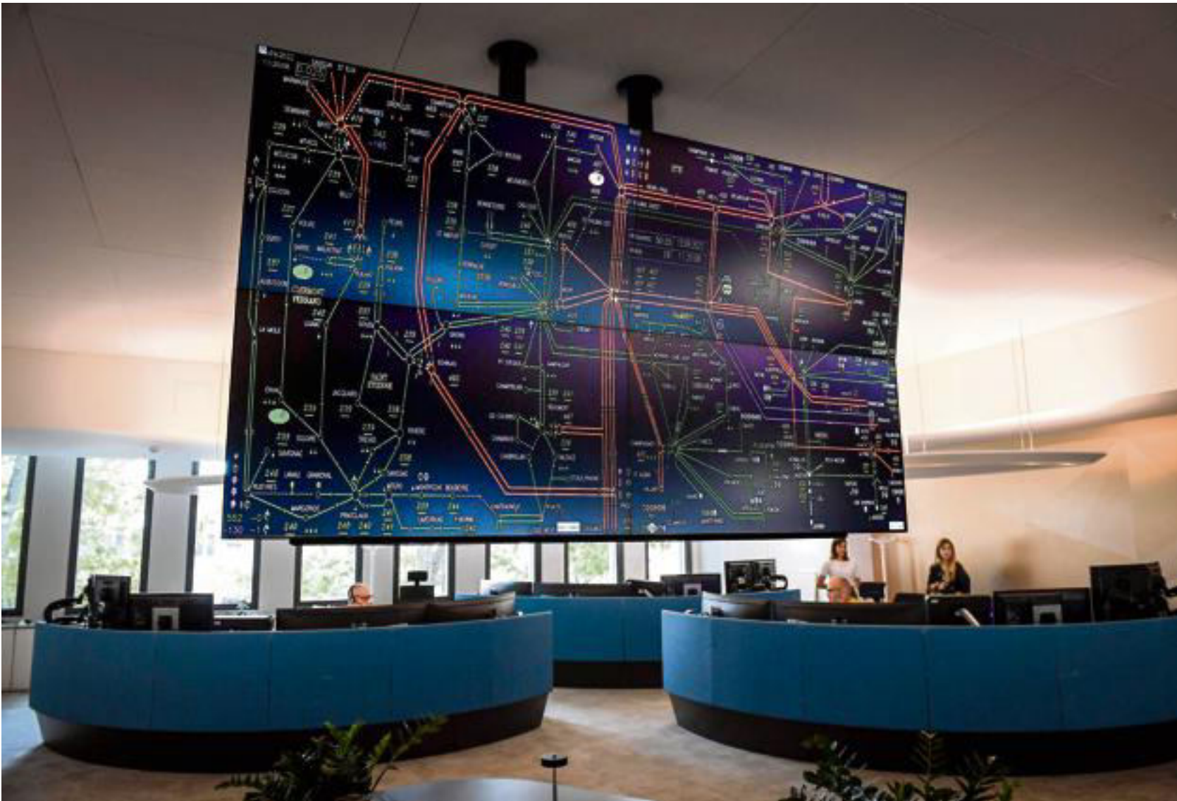
La salle de contrôle de la répartition régionale de RTE, à Lyon, le 15 septembre 2022. JOEL PHILIPPON/PHOTOPQR/MAXPPP
