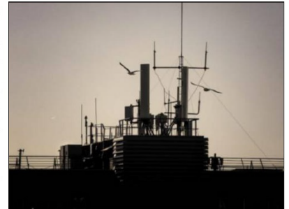
Ces dernières années, les opérateurs télécoms ont en grande partie cédé leurs infrastructures à des sociétés externes. (Photo Frantz Bourton)
