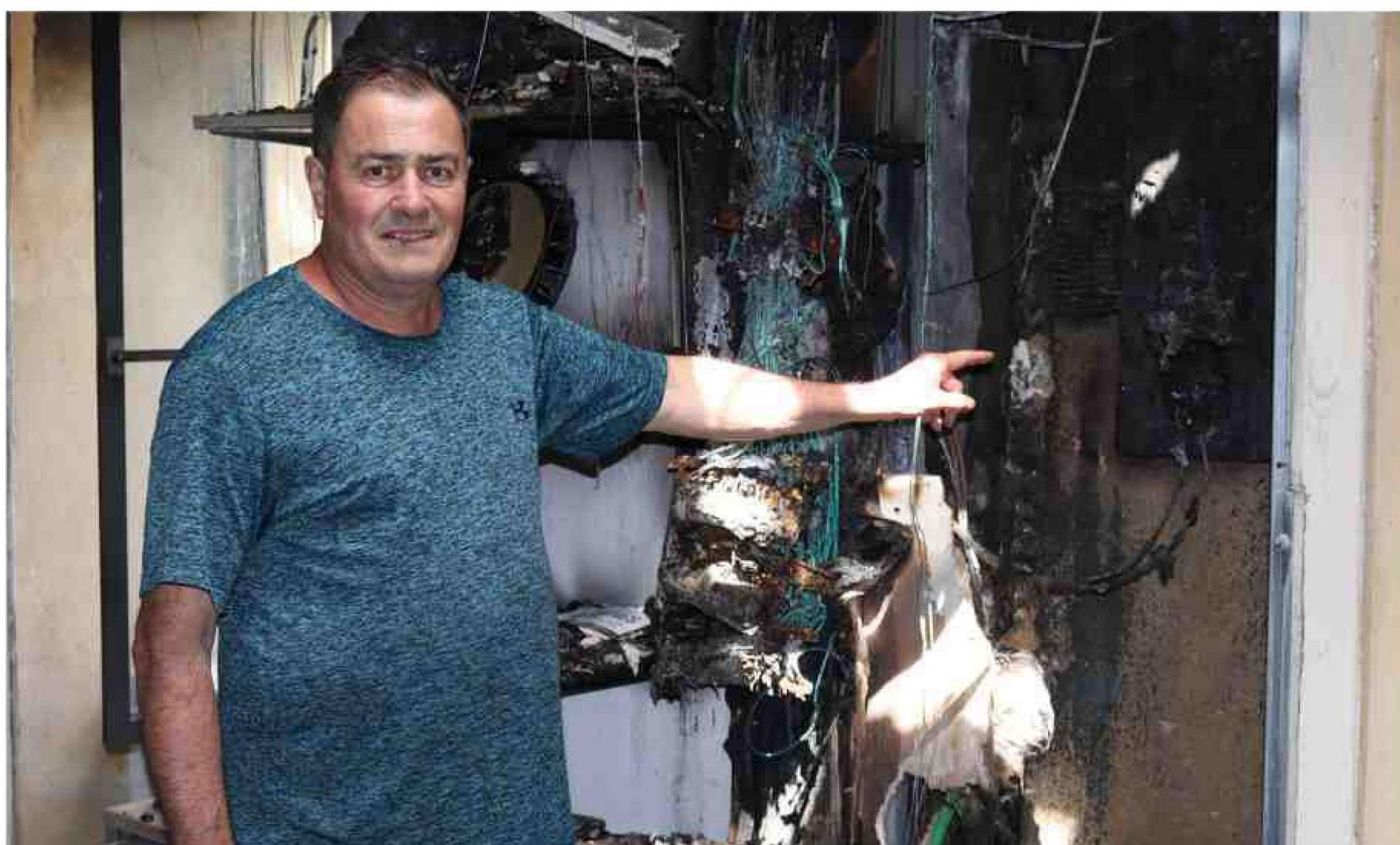
Alain Grugeon estime que c'est au niveau de son compteur Linky que le sinistre s'est déclenché. CL
