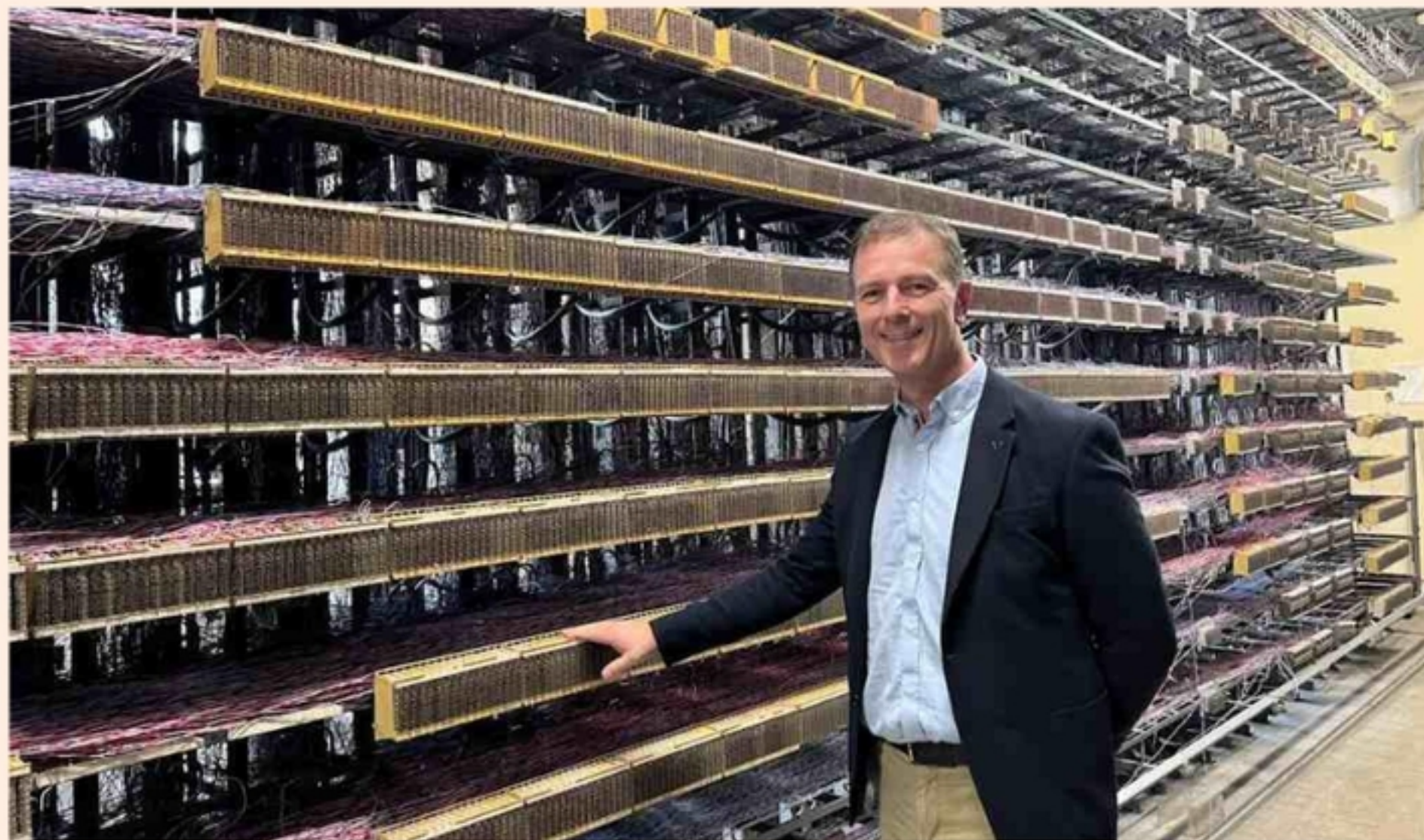
Benjamin Dulong, ici au centre répartiteur d'Anglet, explique les étapes de la fermeture du réseau cuivre. ORANGE
